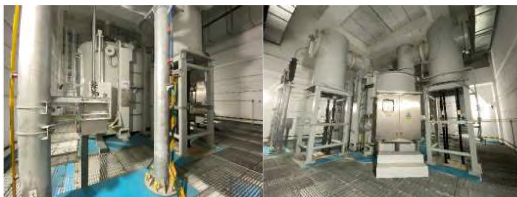
图 2.10-2 双龙变电所主变电设备
